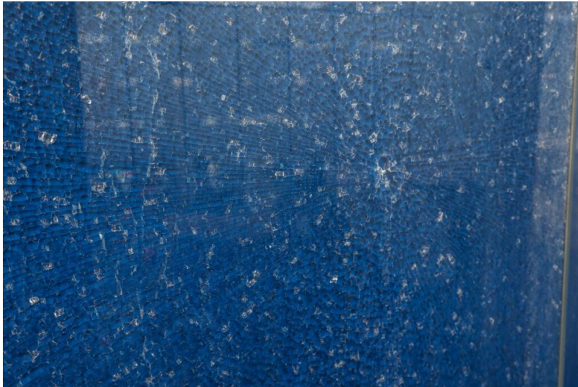
Wohl durch einen Steinhagel wurde die Glasfront der Anlage beschädigt.
