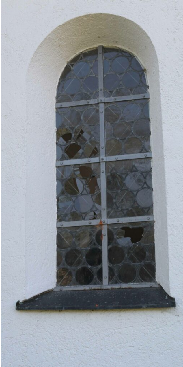
Ein beschädigtes Butzenscheiben-Fenster an der Nordseite der Kirche
